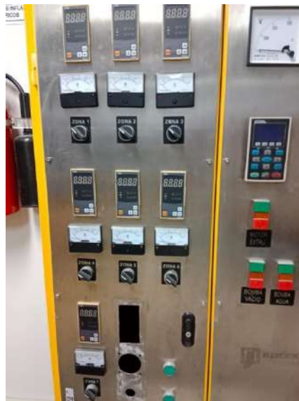
Figura 5. Panel de control de la extrusora.
